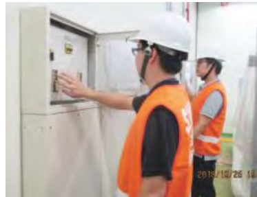
安全防護班-電控箱電源關閉
